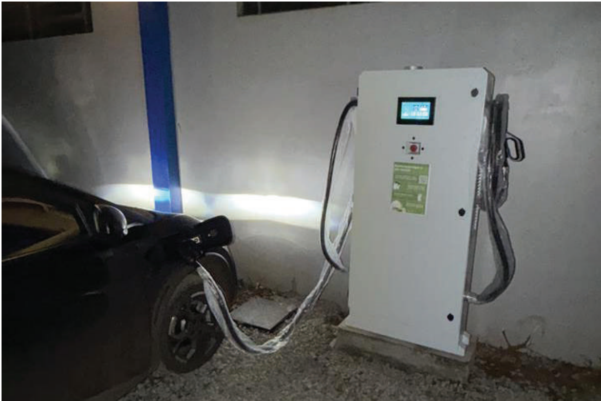
Eletroposto instalado na empresa Eletrocar já está em funcionamento
