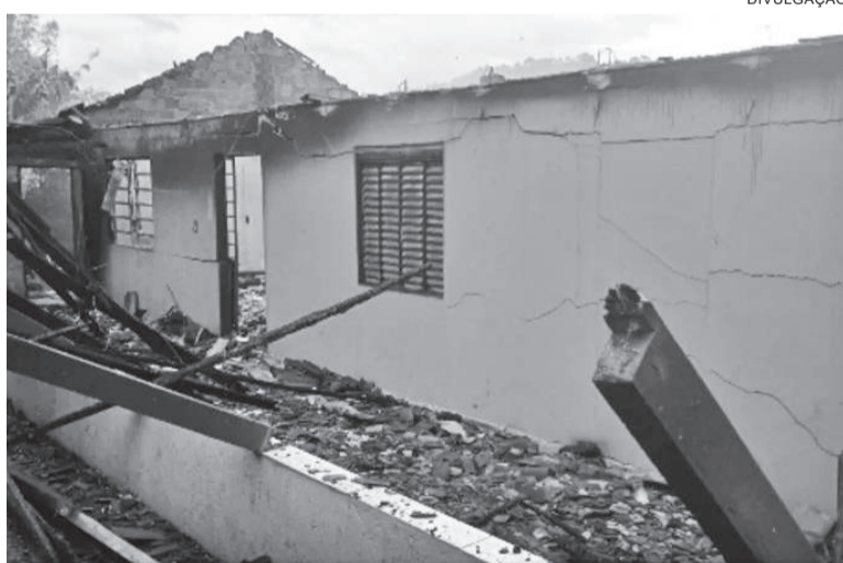
Residência da família Heiss foi completamente destruída pelo fogo
