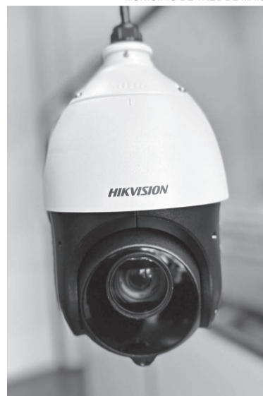
Câmera IP Speed Dome, que está sendo instalada e que integrará a rede de videomonitoramento da cidade
