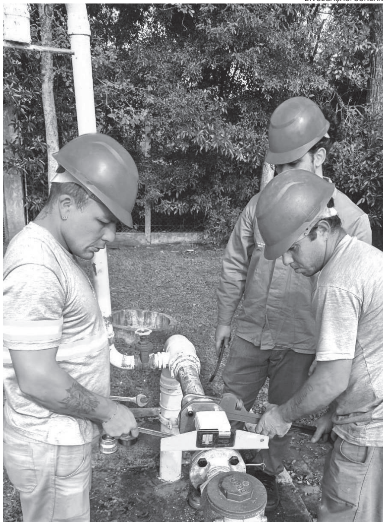
Equipamentos possibilitam comparar os volumes de água que saem dos poços e que chegam aos imóveis. Companhia vai instalar equipamento em Três de Maio
