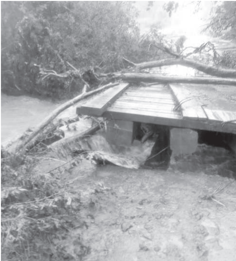
Na localidade de Bom Conselho, distrito de Quaraim, a força da água danificou pontilhão. Secretaria da Agricultura já recuperou ponte
