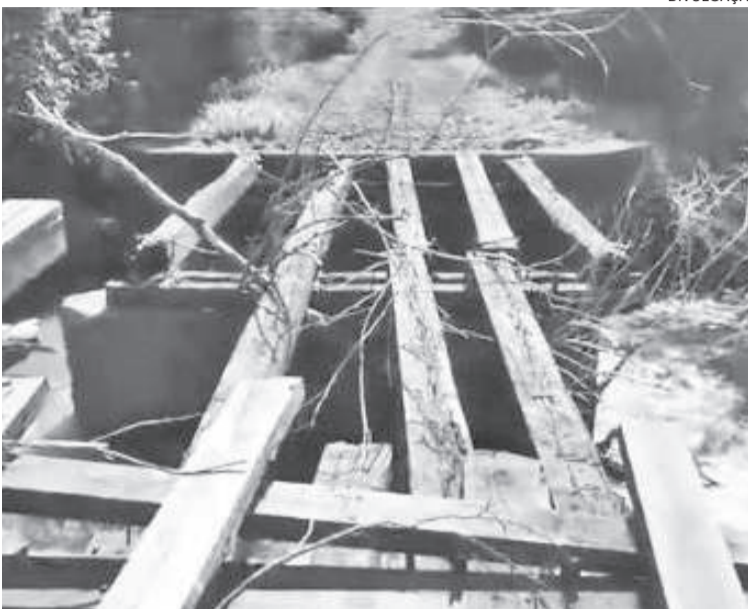
As grandes precipitações de chuva ocasionaram inúmeros prejuízos em pontes, pontilhões e estradas
