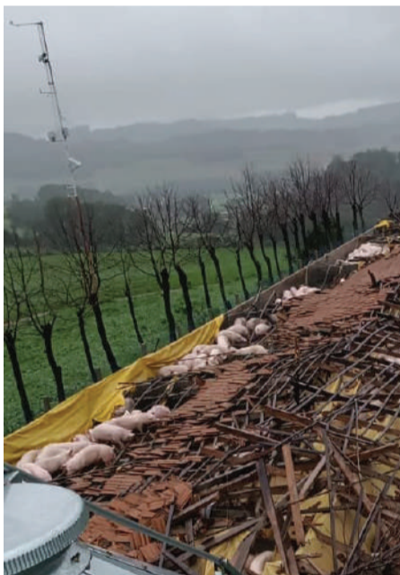
Destruição de chiqueiros causou a morte de dezenas de porcos
