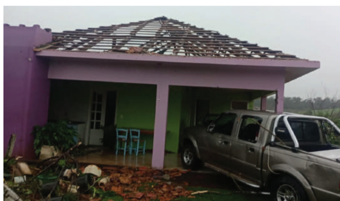
Casas inteiras foram destelhadas
